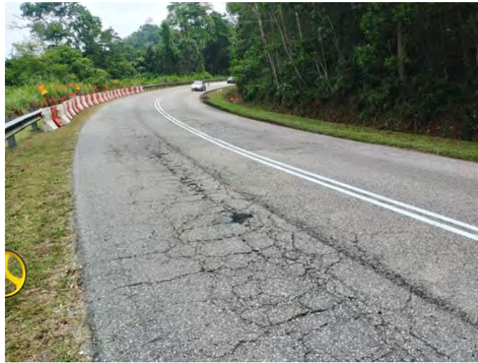
Gambar Rajah 10. Kerosakan Permukaan Jalan
